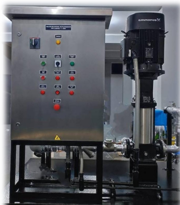
Skid de bombeo para sistema de supresión de polvo - Marcobre.
