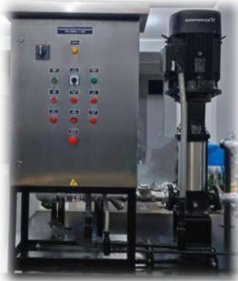
SKID DE BOMBEO
